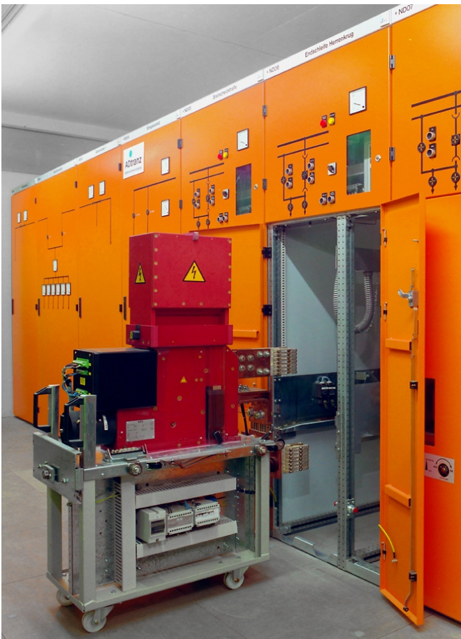
Подстанция постоянного тока с выкатной версией автоматов Gerapid 2607
